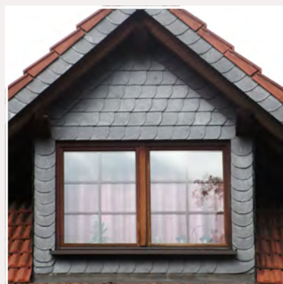
Innenliegende Sprossen (unzulässig)
